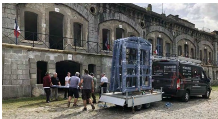
Déchargement des premières menuiseries. C'est PAC Services, entreprise clairoise, qui conduit ce chantier.
